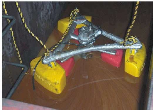
設置於集中冷卻槽
